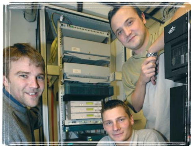
Det store Powerware UPS-anlæg giver optimal sikkerhed. Her ses elinstallatør Henrik Overgaard (til venstre), tekniker Jesper Zengraff og IT-driftchef hos Novasol/dansommer, Søren Hjorth, ved dele af det beskyttede anlæg.
